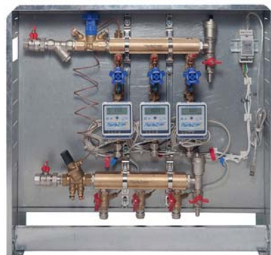
Узел коллекторный этажный
